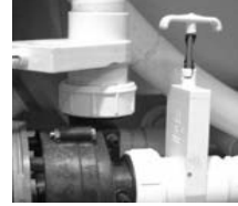
Sperrschieber und Pumpenverschraubung
