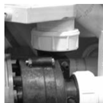
Sperrschieber und Pumpenverschraubung
