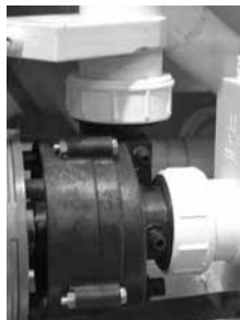
Scheibenventil und Pumpenanschluss
