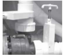
Scheibenventil und Pumpenanschluss
