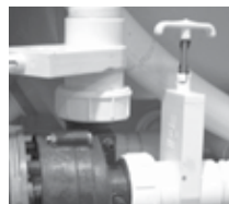
Vanne guillotine et raccord-union de la pompe
