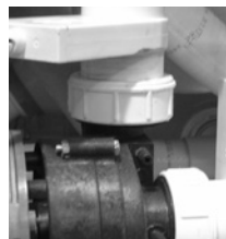
Vanne guillotine et raccord-union de la pompe
