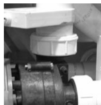
Vanne de coupe et raccord de pompe
