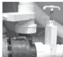
Vanne de coupe et raccord de pompe
